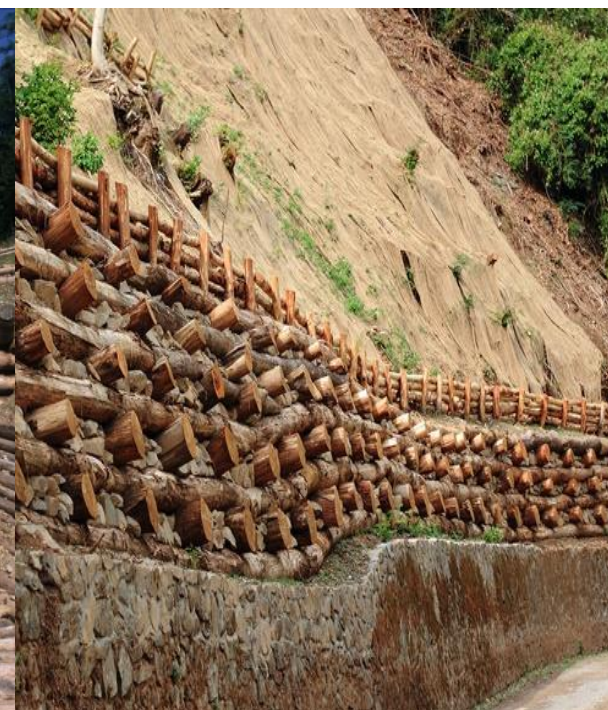
opere spondali di sostegno
