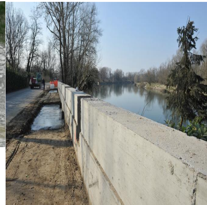
opere spondali di sostegno
